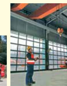
Hallenkranen gem. DGUV 52
